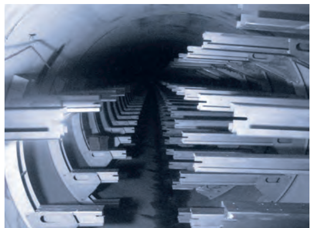
Projekt: Carlton Kabeltunnel, Australien (Bauherr: Energy Australien, Ausführendes Unternehmen: The Abergeldie Group, Kabeltrassen: Leviat)
